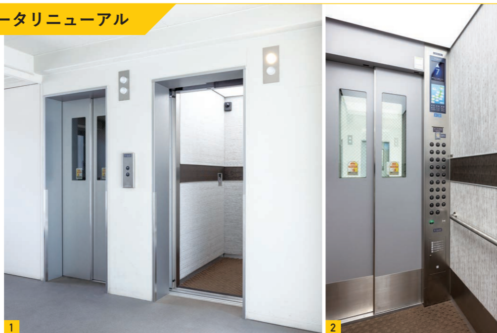
1 「晴海アイランドトリトンスクエアアーバンタワー」のリニューアルしたエレベーター外観 2 リニューアル前と比べ、内装も高層マンションにふさわしい落ち着いたデザインに
